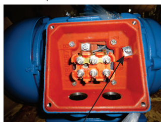
Figura B - Punto de conexión a tierra del motor eléctrico
