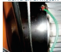
Punto de puesta a tierra en el motor.
