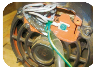
Ponto de aterramento existente no motor
