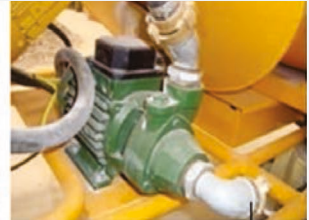
Filtro bomba de agua
